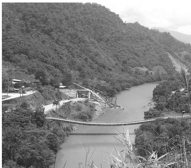
Caída del nuevo puente.
