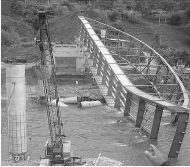
Estado en que quedó.
